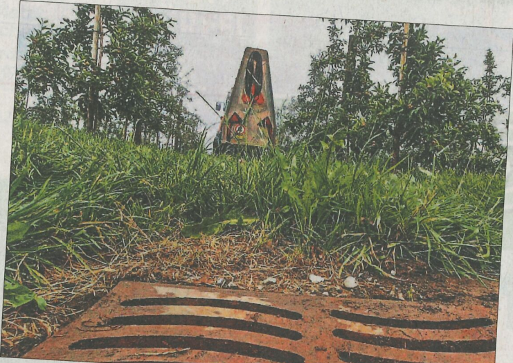
Freiliegender Schächte sind ein Risiko. (Bild: Arenenberg)
