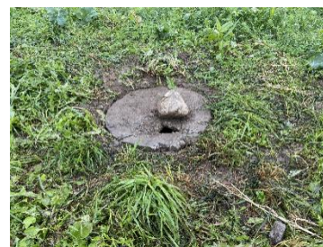
Abb.: Defekter Schachtdeckel innerhalb der landwirtschaftlichen Nutzfläche
