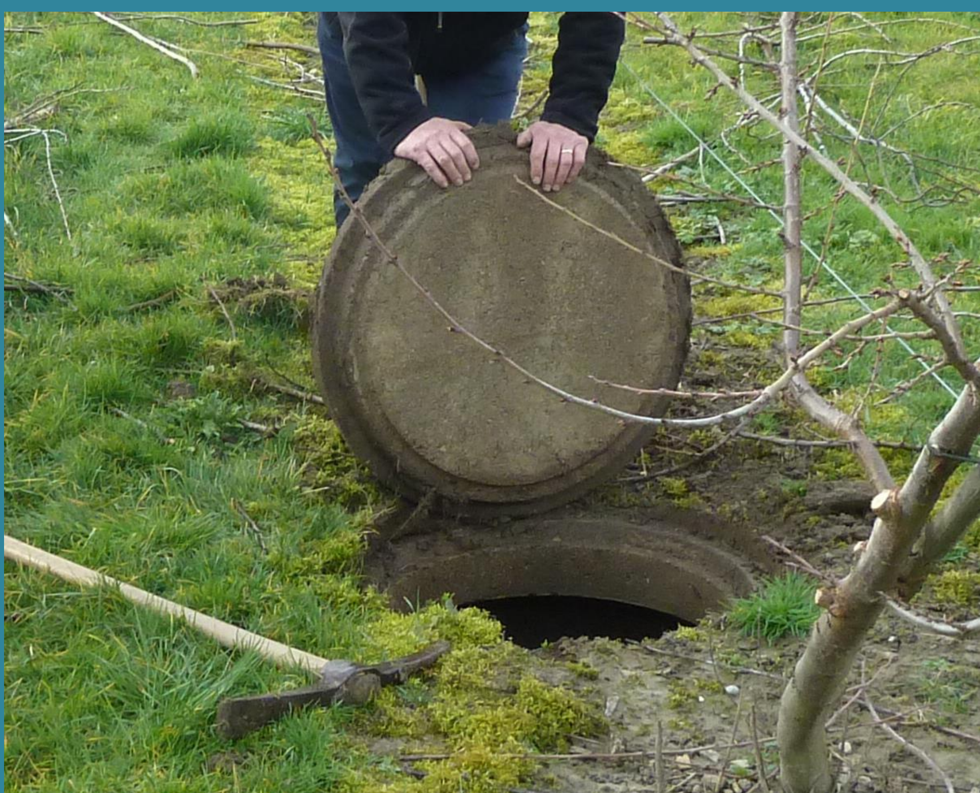
Geschlossene Deckel von Kontrollschächten
