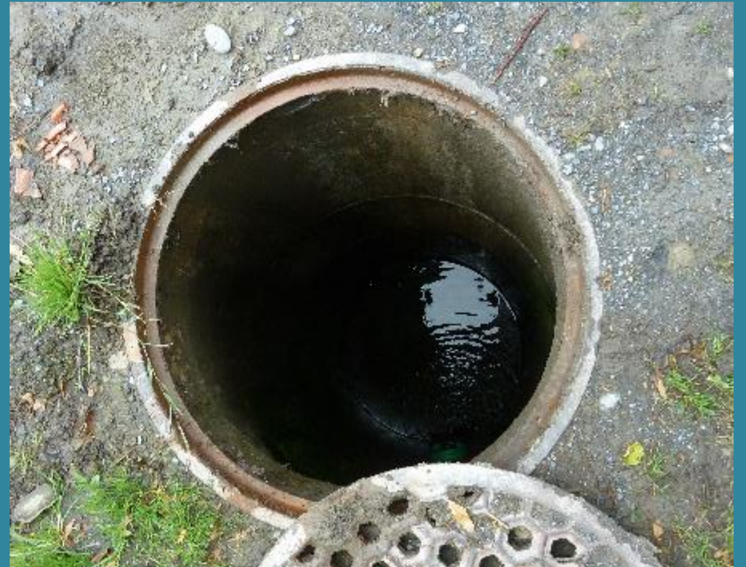
Regelmässige Reinigung der Sammelschächte
