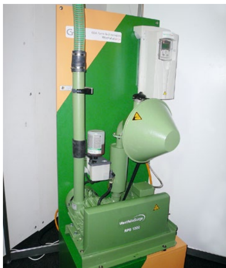
Vakuumpumpe mit Frequenzsteuerung. (Fotos: Bamos AG)
